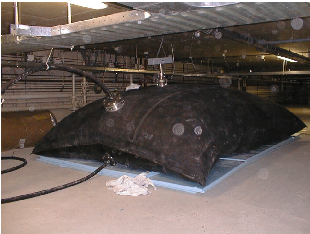
Figuur 9.23 Waterzak in ongeïsoleerde toestand met flenzen voor het inbrengen van de sproeileidingen. Verder is boven in de waterzak een thermokoppelboom geplaatst voor het meten van de stratificatie
